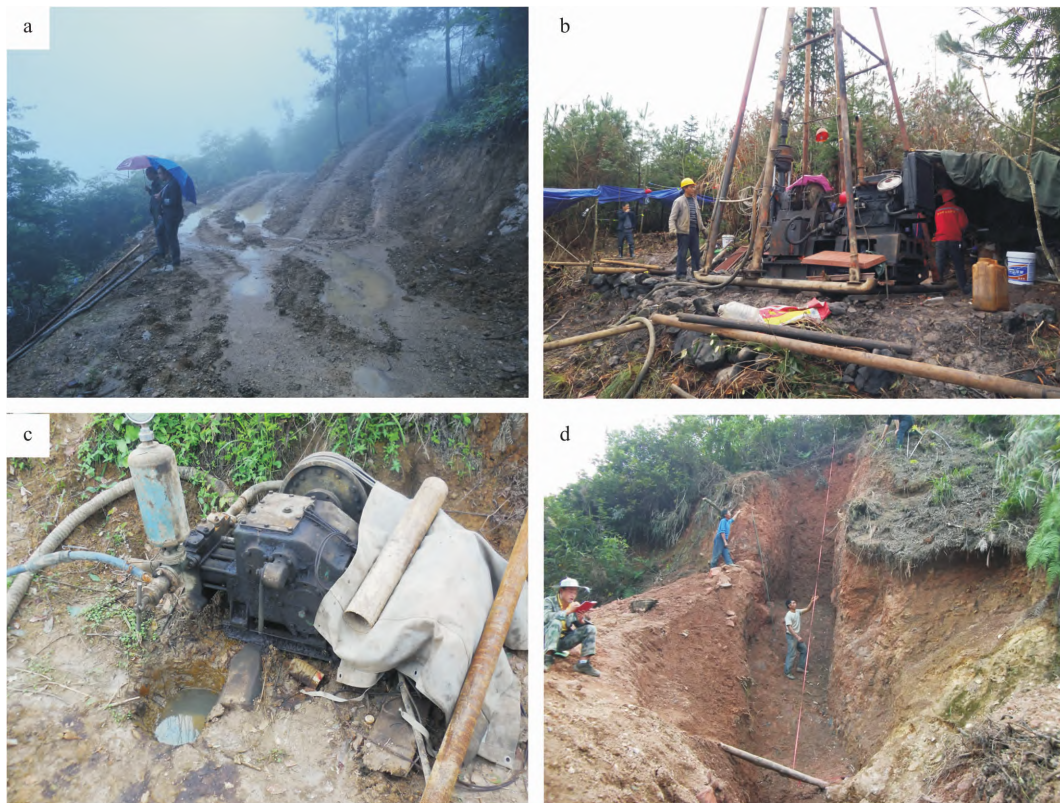
a. 修筑进场道路破坏生态环境；b. 机台布置不合理、工器具随意堆放等破坏生态环境；c. 机器老化漏油污染土壤；d. 开挖探槽破坏环境
